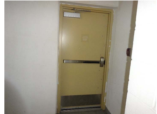
Metal fire door
