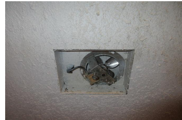
Storage room exhaust fan
