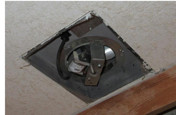
Storage room exhaust fan
