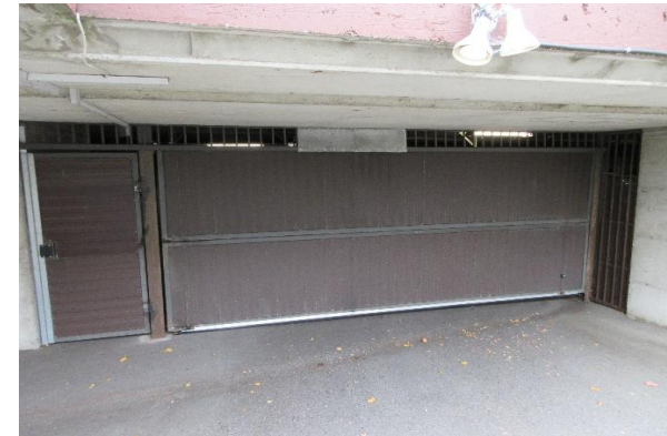
Metal overhead garage door
